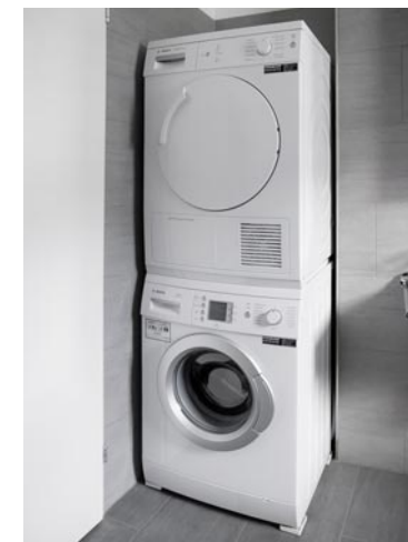
Sie waschen, wann Sie wollen: Waschmaschine und Tumbler in jeder Wohnung. Ausserdem ein Raumluft-Wäschetrockner im Untergeschoss.
